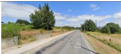
Avda de Cospeito. Beirarrúa nunha soa marxe e con problemas de accesibilidade
